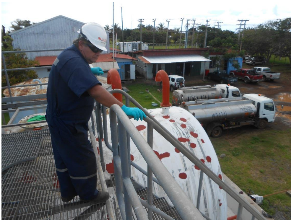
Central Eléctrica Mataveri – Estanques de Petróleo
