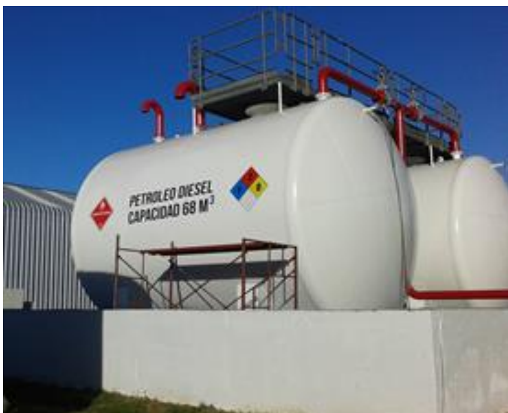
Estanques petróleo, Central eléctrica
