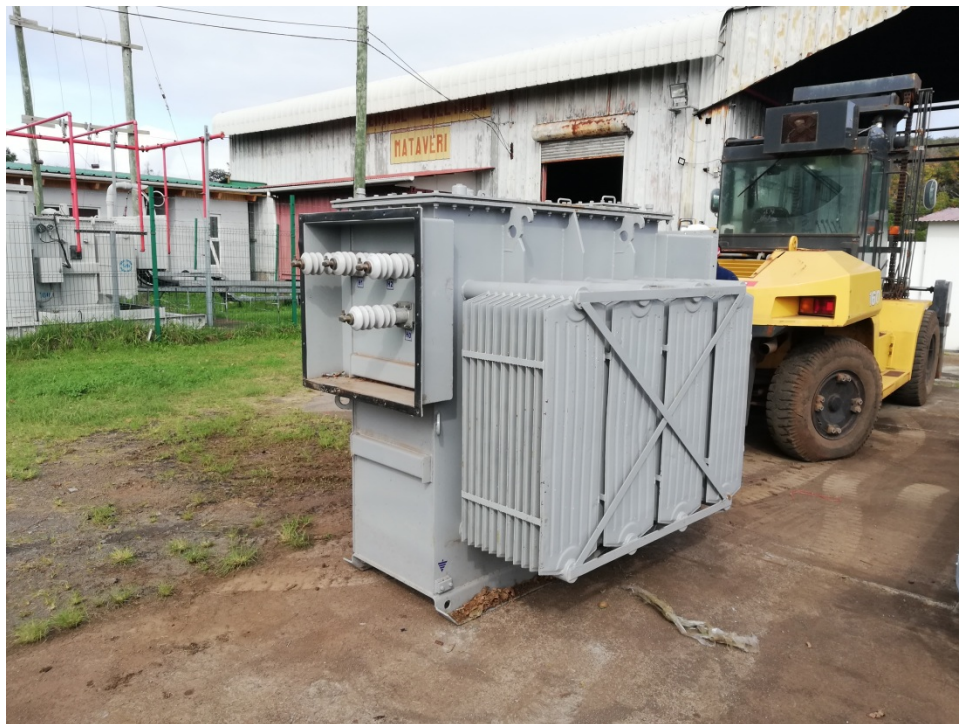
Fotografía: transformador sin la celda de MT
