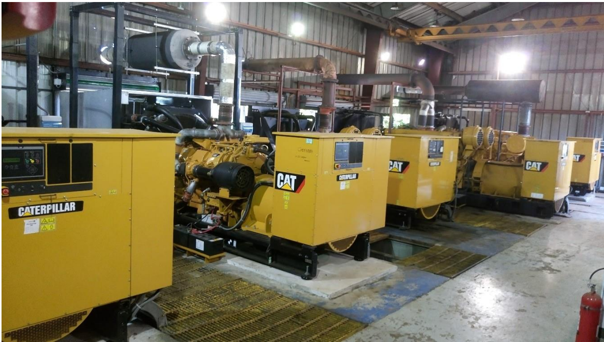
Figura 2.- Ubicación de los grupos electrógenos en la Central Mataveri
