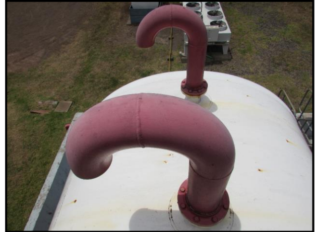
Fotografía N°6: muestra registro de venteos instalados en la parte superior del tanque.
