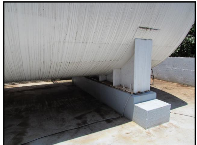
Fotografía N°4: muestra vista general de ubicación de silla de anclaje, parte trasera del tanque.
