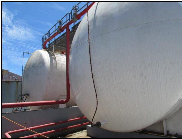
Fotografía N°1: muestra vista general de los niveles de manguera instalados en tanque.
